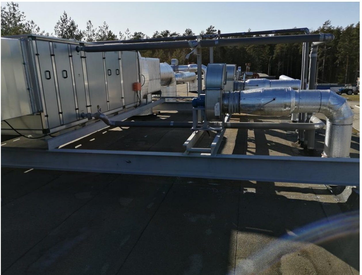
Приточно-вытяжная вентсистема зд.105
