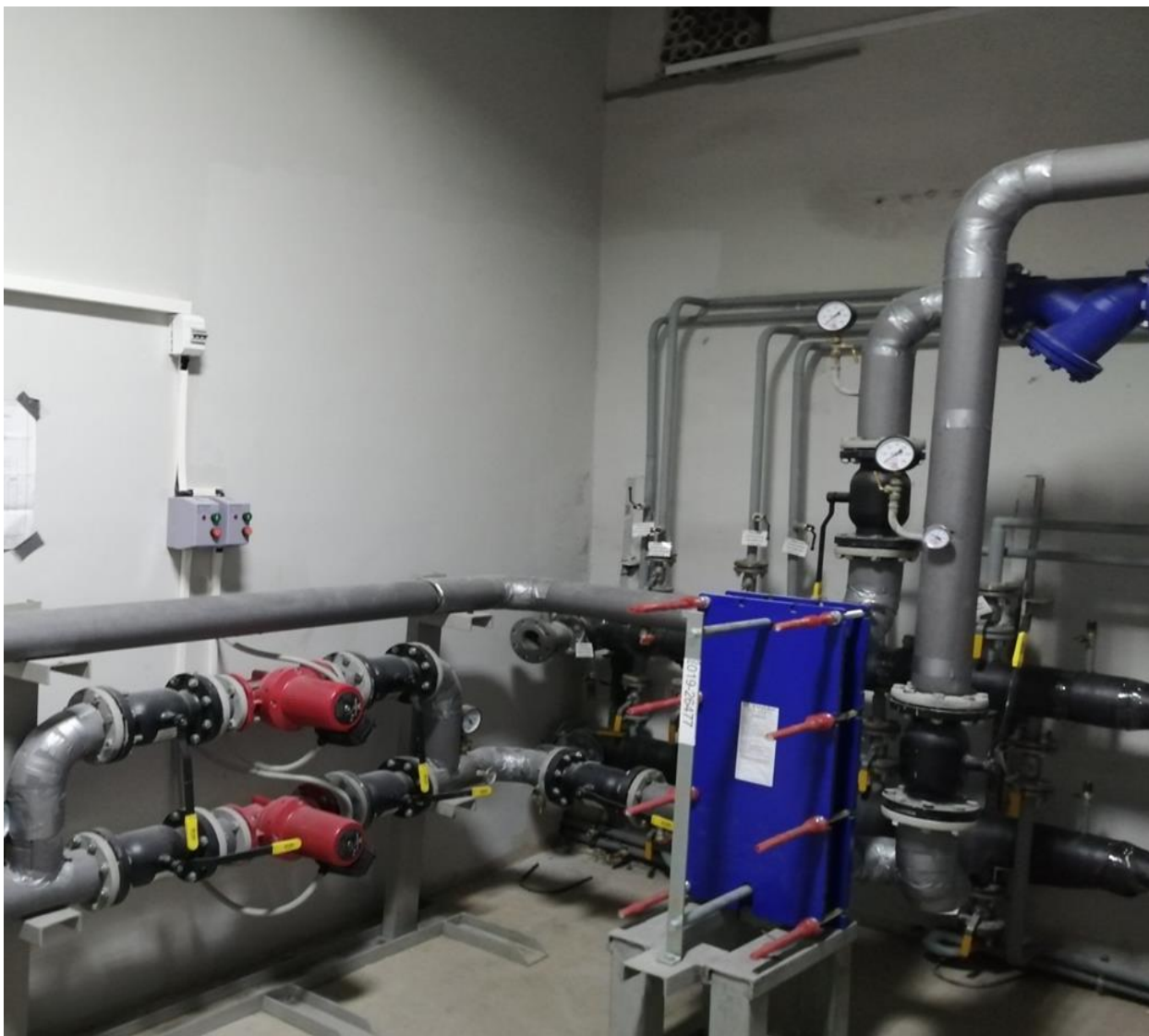
Автоматический тепловой пункт зд.105
