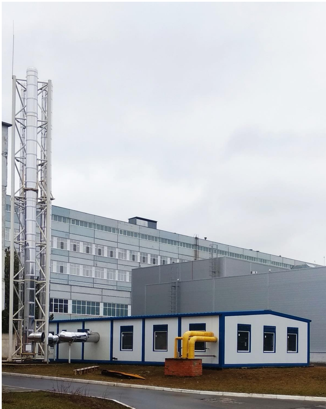
Блочно-модульная котельная ТКУ-6,0МВт
