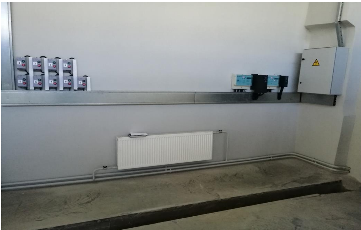
Система управления приточно-вытяжными вентсистемами зд.105
